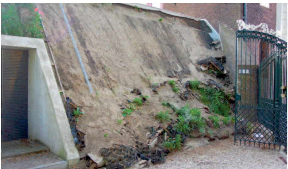
(9) Abgerutschtes begrüntes Steildach: Ursache ist eine ungeeignete Rutschsicherung.
