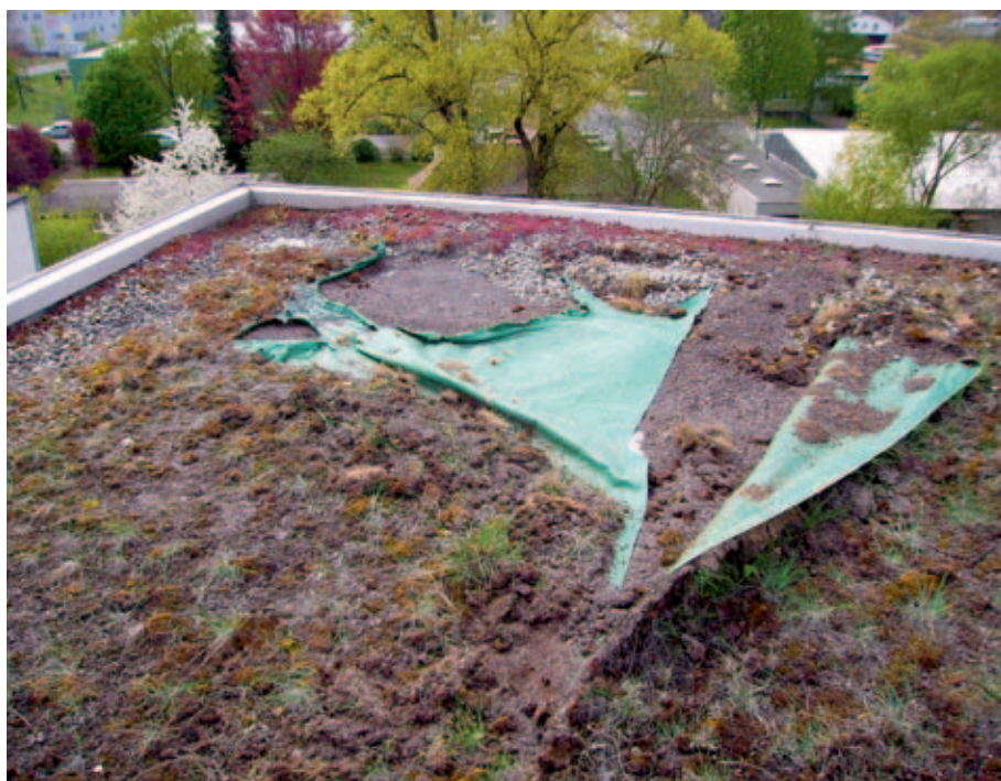
(7) Windverwehungen bei einem höheren Gebäude – der Aufbau war nicht verwehsicher.
