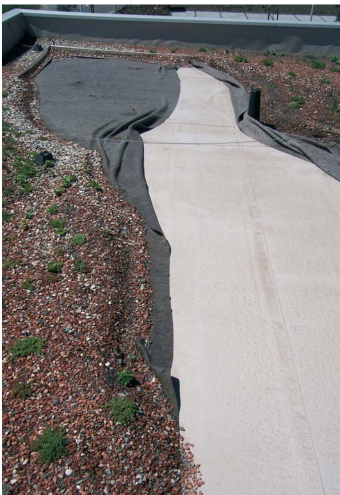
Verwehungen, die in diesem Fall bis auf die Dachabdichtung gehen
