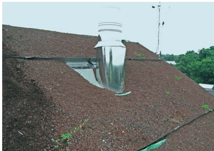
Aufgehende Bauteile sind auch windgefährdet.
